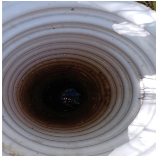
Plastrør i deponiet ved siden af den dybe brønd- Vandstand er cirka 1 meter under terræn
