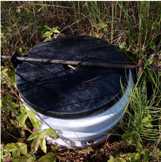
Dyb brønd er aflåst - placeret ved bund af etape 2.2A
