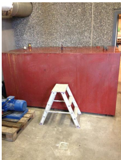
Gasolietank. Olien bruges til opvarmning af vand til generering af damp.
