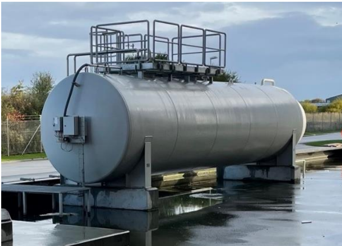
Figur 3-9 Dieselolietank placeret i spejlbassin nord.
