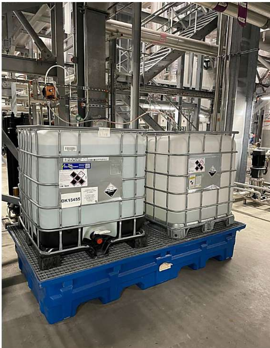
Figur 3-6 NaOH tanke på flisværk placeret på opsamlingskar
