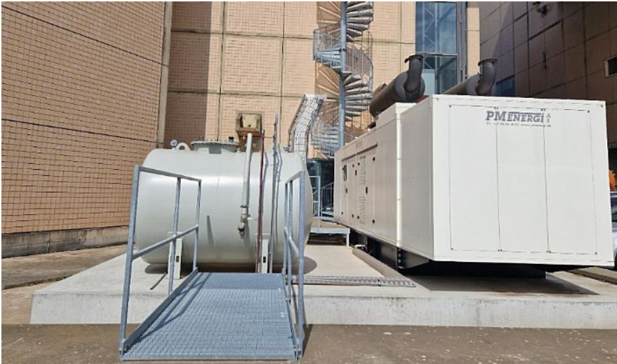
Figur 2-8 Nødstrømsanlæg og tank til opbevaring af diesellole i spejlbassin syd
