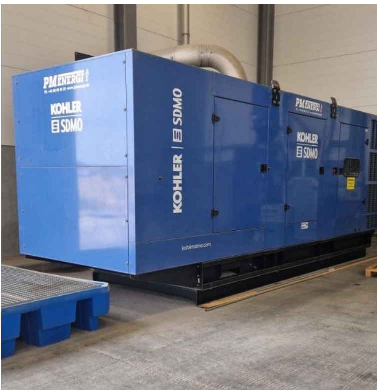
Figur 2-9 Nødstrømsanlæg ved biomasseværket
