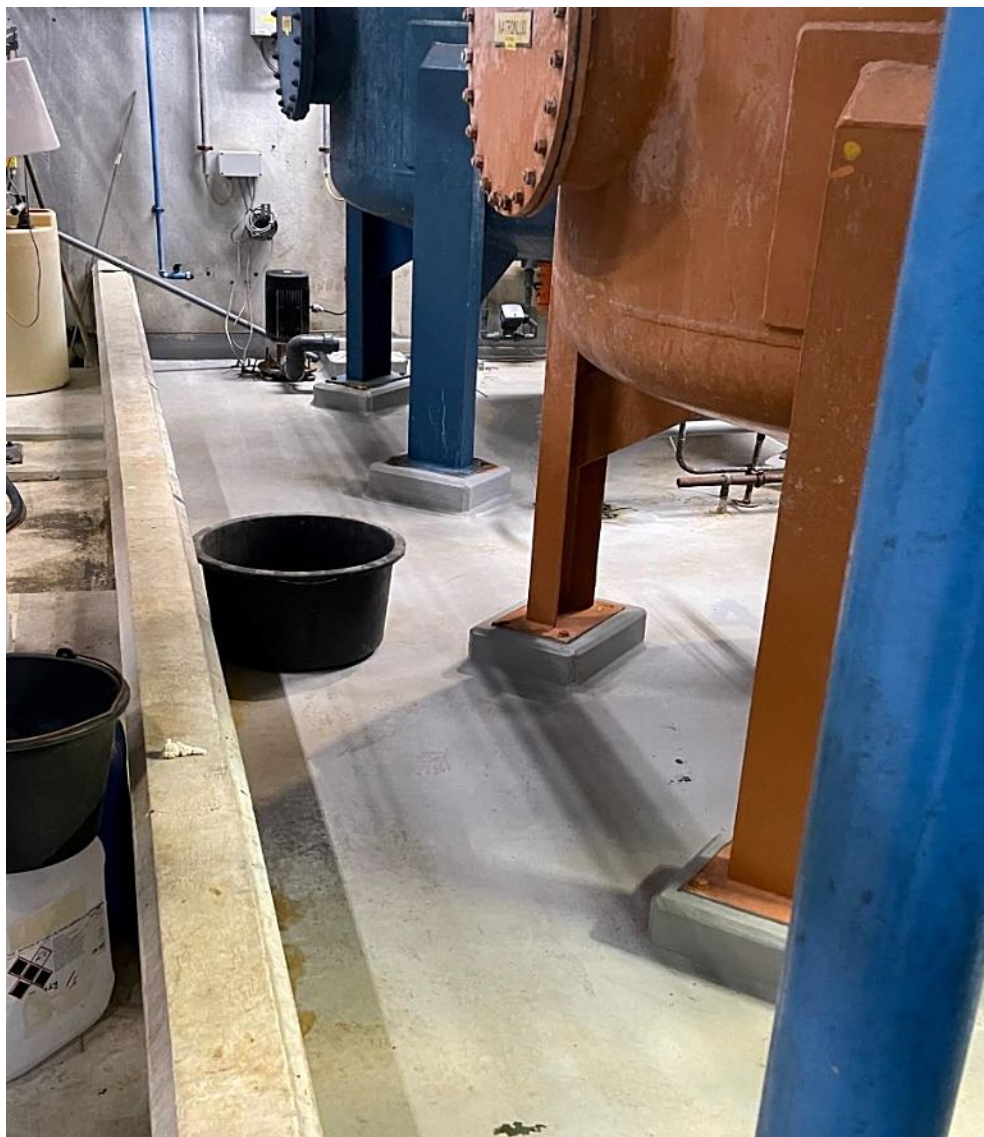
Figur 3-8 Opsamlingsbassin under saltsyre og lud lagertanke i vandbehandlingsrum
