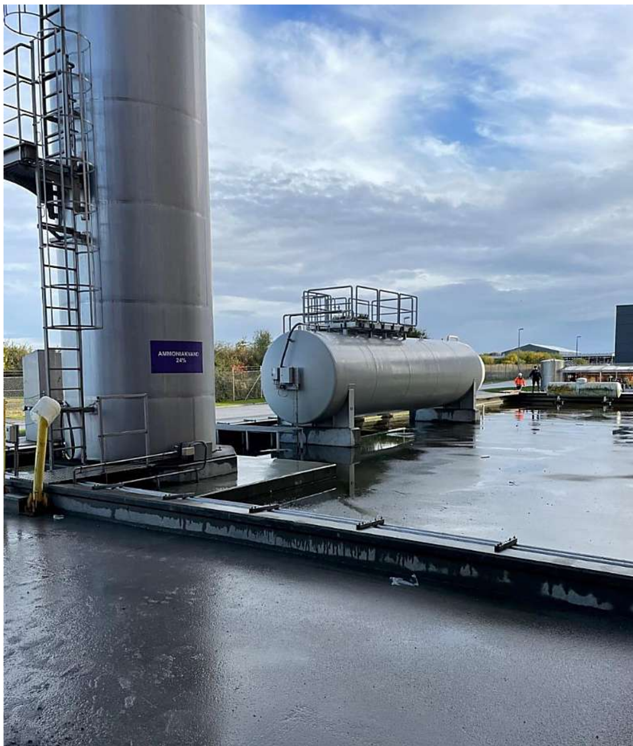
Figur 3-3 Spejlbassin Nord der viser placering af tank til ammoniakvand (lodret beholder i den nærmeste ende af bassinet), gasolietank (vandret tank i midten af bassinet) og tank til propangas (vandret tank i fjerneste ende af bassinet)
