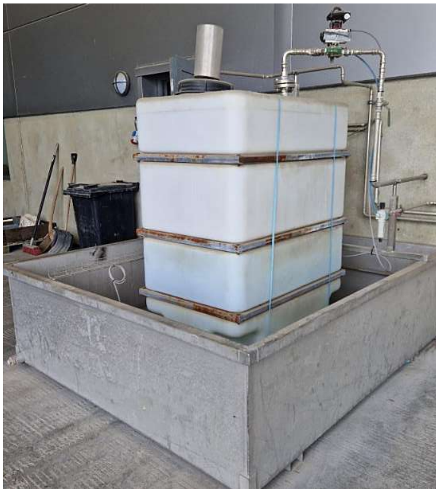
Figur 3-4 Buffertank af ammoniakvand ved biomasseværket
