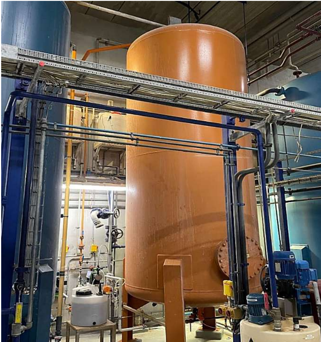
Figur 3-5 NaOH lagertank med doseringsenhed til røggaskondensering affaldskedler
