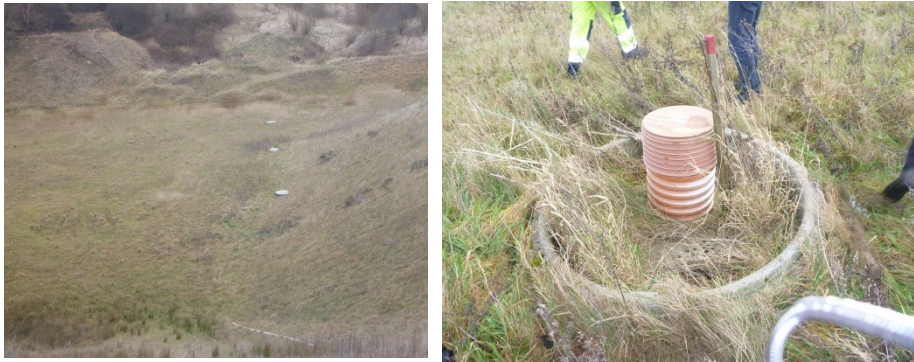
Figur 13 Monitoringsbrønde M1, M2 og M3 anes i bunden af området nord for skrænten. Udløb fra dræn på skrænten ses nederst (TV). Kontrol/Inspektionsbrønd placeret i dybdepunktet for sætningsområdet på etape B-C (TH).
