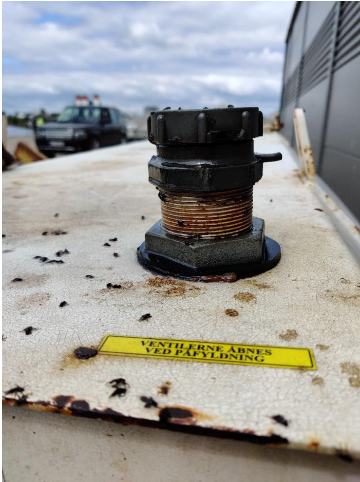
Påfyldnings- studs med tegn på overløb.
