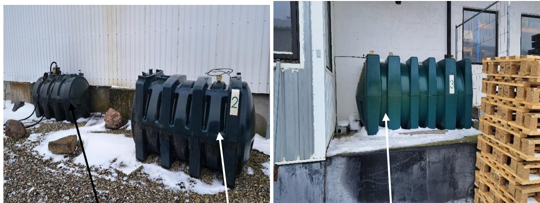
Billede nr. 19: Dieseltank (tank nr. 2), ikke i brug (tank 3) og fyringsolietank (tank nr. 5) (2024)
