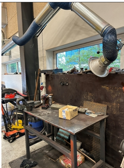
Slibeplads i værkstedet med udsugningssystem med filter.
