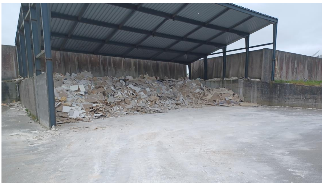
Figur 7 Øverst til venstre. Afløb fra gipspladsen er vokset til og gipspladsen har ikke hældning mod afløbet. Øverst til højre er billede af blotlagt afløb. Nederst er billede af gipsoplag.
