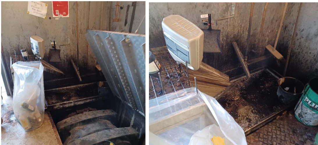
Figur 1 Spild af spildolie omkring aftapningspladen og ned på spildolietanken og op ad væggen. Øverst: Nedsænket tank. Nederst tv: Sump ved modtagestation for spildolie. Nederst th: Modtagestation for spildolie.
