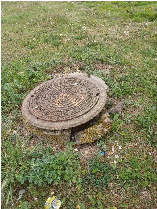
Figur 10 Defekt brønddæksel omkring en formodet perkolatbrønd på arealet ved enten afd. 1b eller 4.3.
