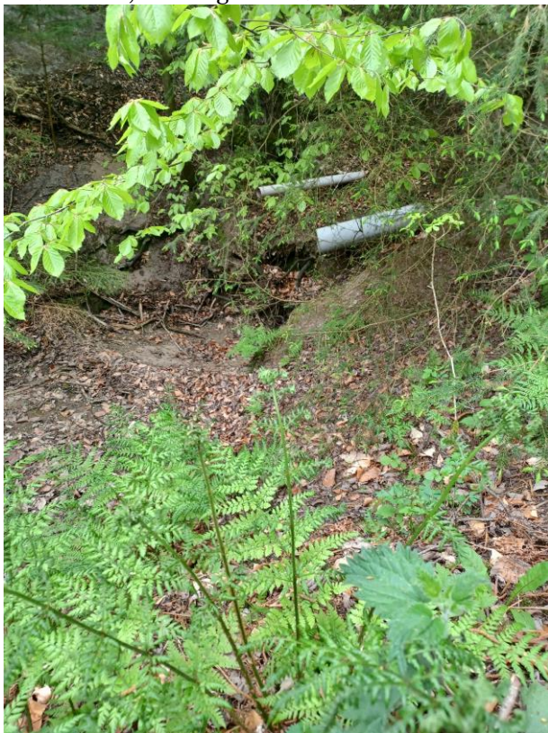
Figur 11 2 udløbsrør til skoven bagved perkolatbrønd P202. Silkeborg Genbrug og Affald skal redegøre for hvad der afledes hertil, og såfremt der ingen afledning er, skal rørene afkobles.
