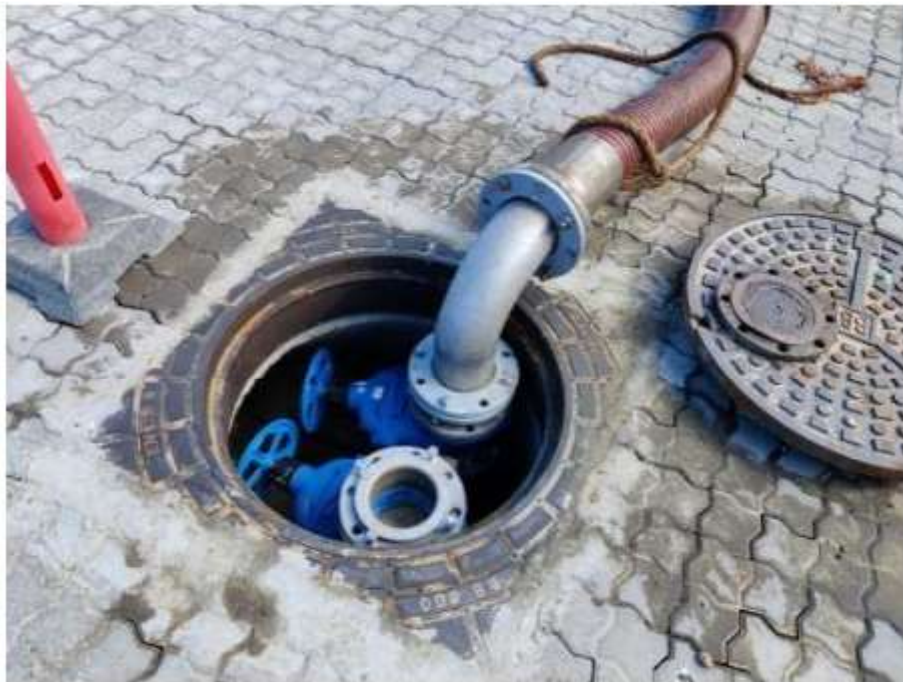
Figur 4 Brønd med tilkoblingsstuds til havneledninger
