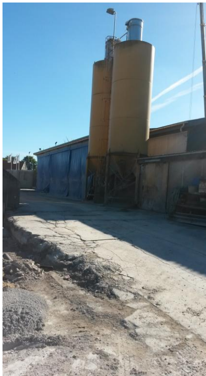
Cyklon og filtre på cement siloer
