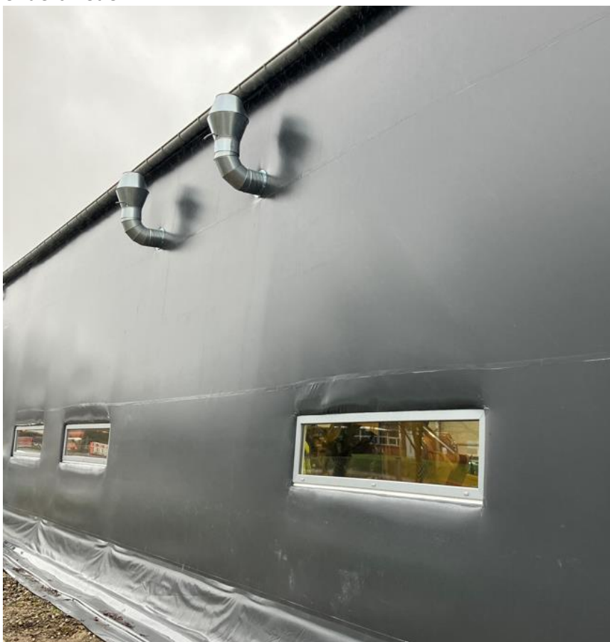
Billede 2. Billede af telthallens 2 afkast fra udsugningsanlægget for udstødningsgasser.
