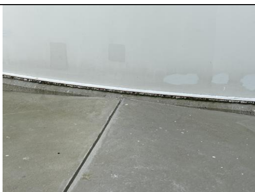
Hævning af terræn ses også ved tank 4.
