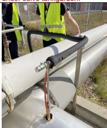
Aflastningsrør til HFO-røret til kaj 9. Aflastningsrøret lækkede med spild til pumpegruppen i april 2021.
