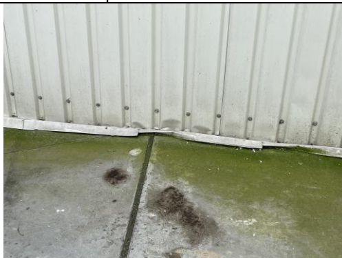
Hævning af terræn ved tank 2, der betyder, at tankplader deformeres.
