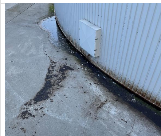
Udsivning af olie ved tank 1 startede i november 2020 og pågår stadig.
