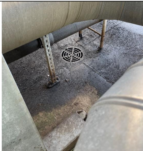
Oliespild ved afløb.
