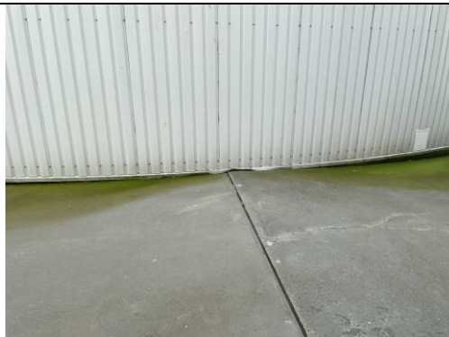
Det aftaltes på tilsynet, at alle fuger kontrolleres for, at de til stadighed er tætte. Virksomheden skal tillige undersøge hvorvidt, der er membran under selve tankgården.
