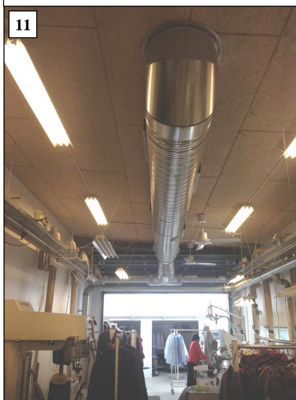
Foto 11 af Ventilationsrør i finish-afdelingen
