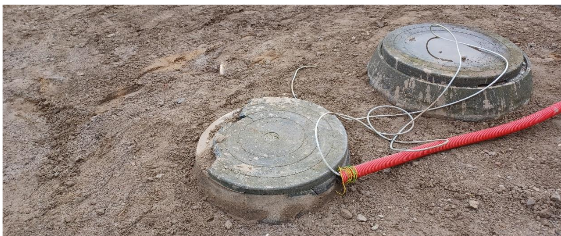
Figur 6. Afgravning af jord. Øverst: Afgravet jord i container. Midterst tv: Vand i container. Midterst th: Retablering af terræn under stige. Nederst: Skadet brønd og dæksel til olieudskiller.
