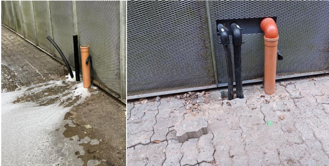
Figur 2. Første spild. Tv: Det første spild skete fra indløbsrøret til renseanlægget (midterste rør). Kilde: Renosyd's redegørelse for spild fremsendt til Miljøstyrelsen den 5. marts 2024. Th: På tilsynet var rørene blevet tilsluttet rør inde i bygningen.
