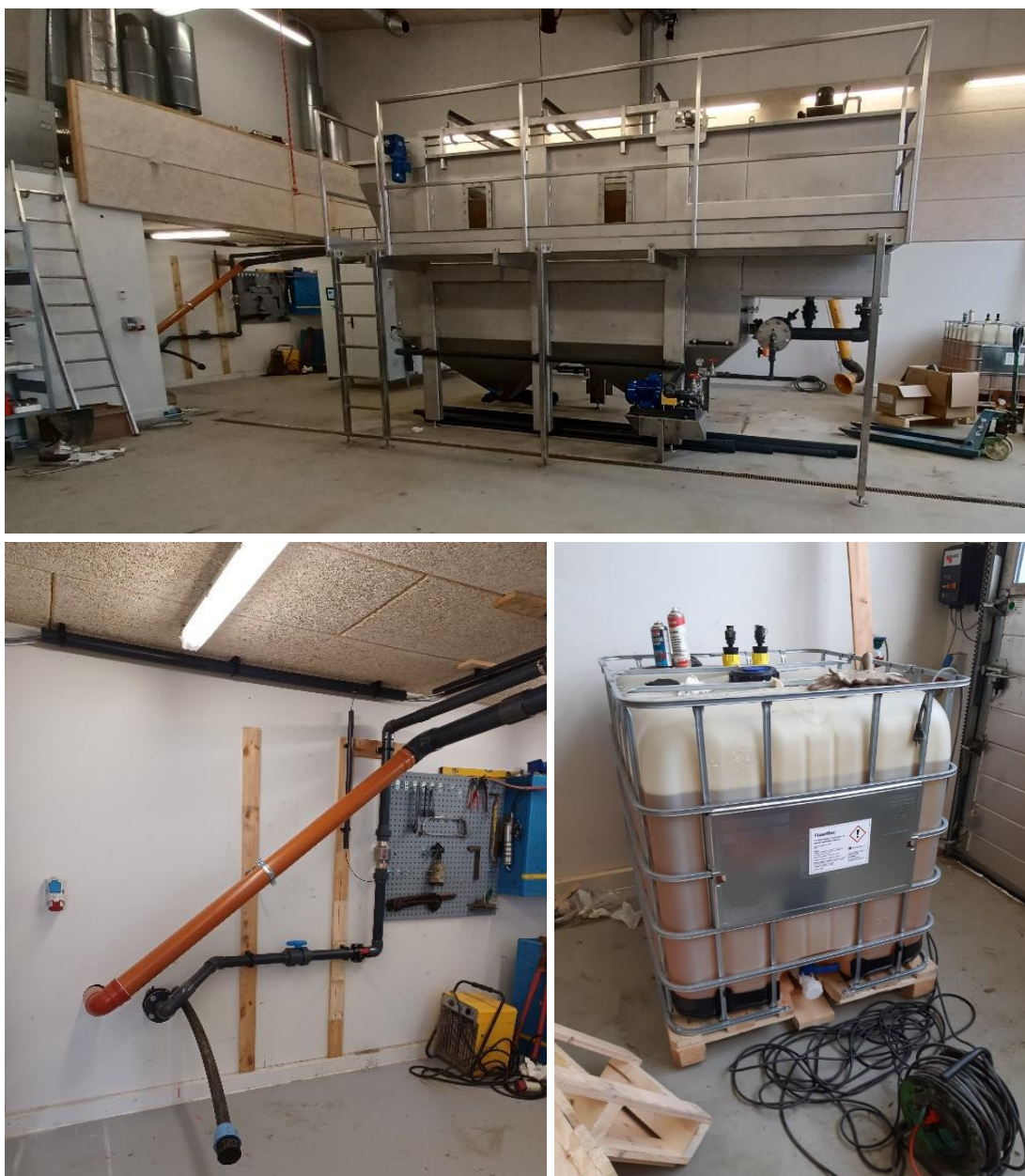
Figur 8. PFAS-renselanlæg og kemi. Øverst: Perkolatfyldt opsamlingstank. Nederst tv: Rørføring til opsamlingstank, som gennem væggen kobles til udvendige rør. Nederst th: Kemitanke indeholdende Flourfloc.
