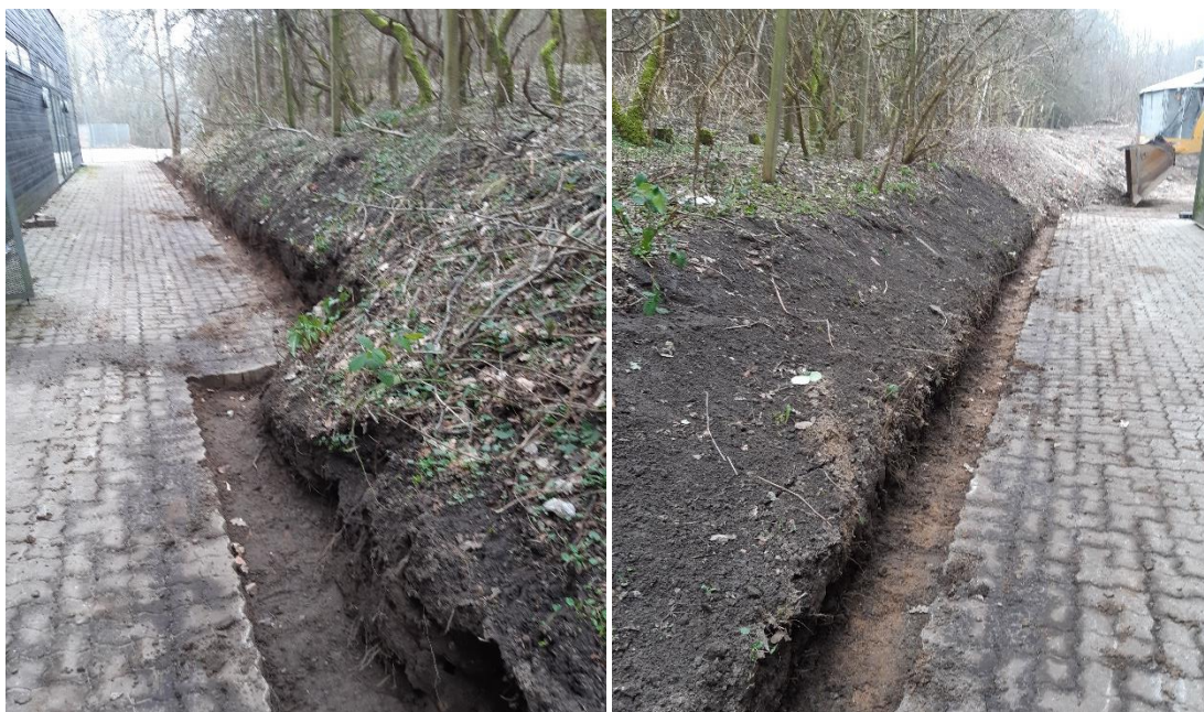
Figur 4. Spredning af spild mod syd og vest. Øverst: Gruspladsen syd for tanken efter afgraving. Nederst: Gravet rende vest for værkstedsbygning, tv: kig mod syd, th: kig mod nord.
