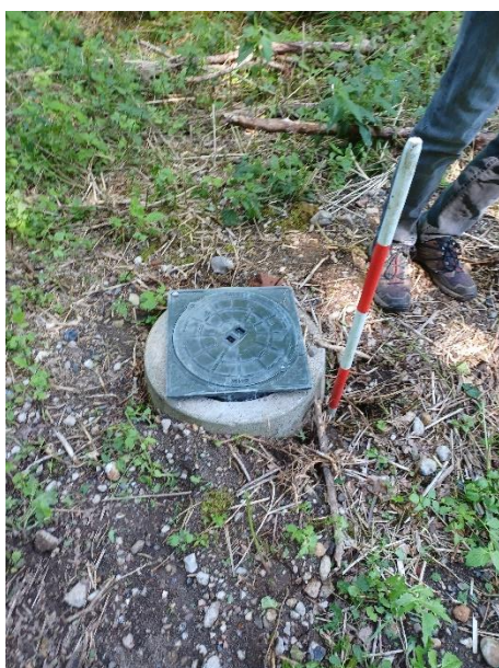
Billede 6 Brønd, hvis formål ikke kunne afklares ved tilsynet 21. juni 2022.
