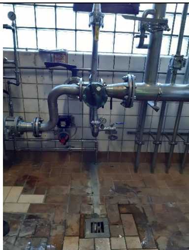
Tilkoblingssted for vand og skum i pumpehus 2. Afløb til eget rensningsanlæg.
