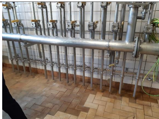
Ventiler i pumpehus 2 til fordeling af skum i tilfælde af brand. Anlægget betjenes manuelt.
