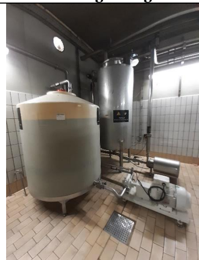
Skumtank ved inddamper 8, der er afløb til eget rensningsanlæg.
