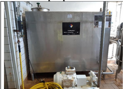
Skumtank ved pumpehus 2
