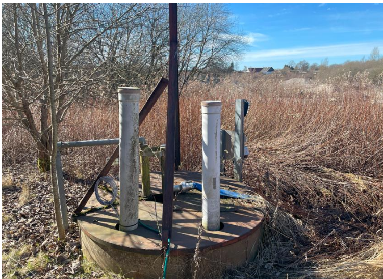
Hovedbrønd med nedsænket pumpe og løfteanordning.
