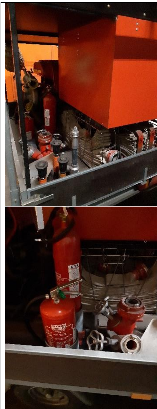
Brandslukningsanlæg er placeret inden døre i garage på en trailer.
