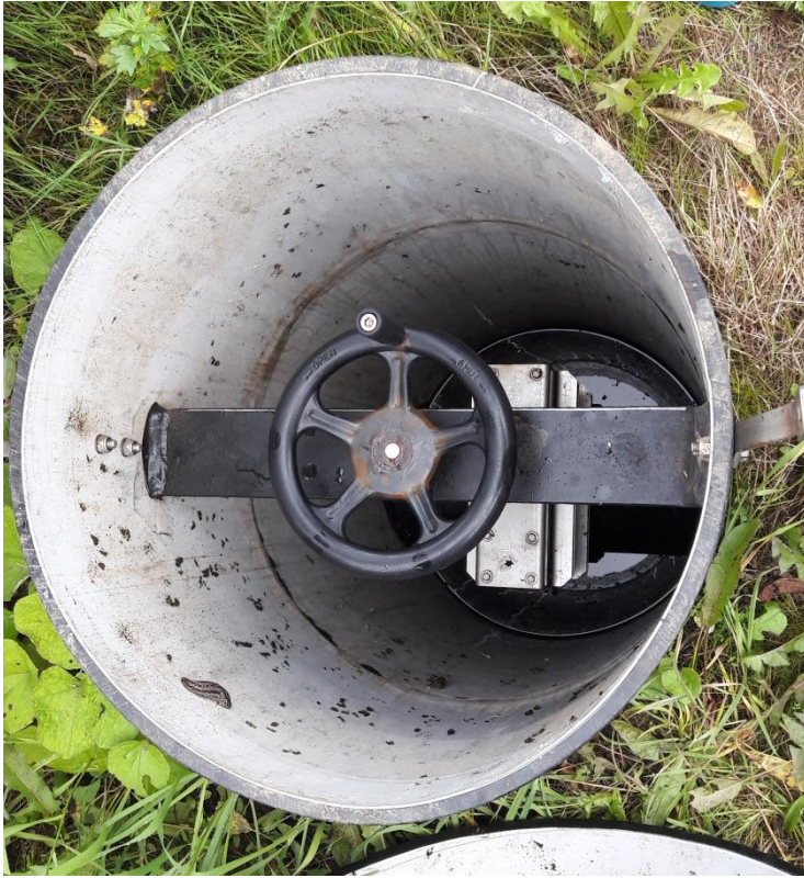
Foto 7: Brøndventil til aflukning af udløb fra etape syd til Vejle Fjord.
