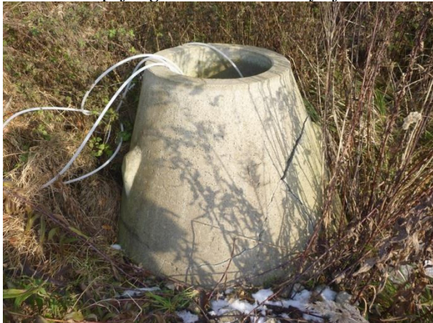
Billede 2. Revnet betonring ved boring B204
