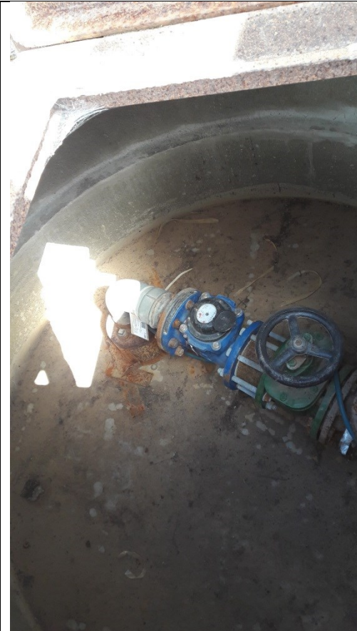
Boringen er en vandforsyningsboring som anvendes af Nymølle Stenindustri.
