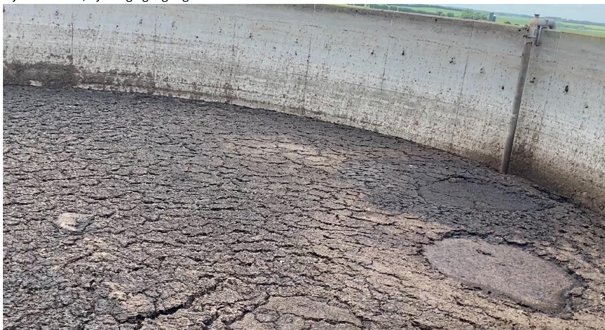
Gyllebeholder, dykket indløb
