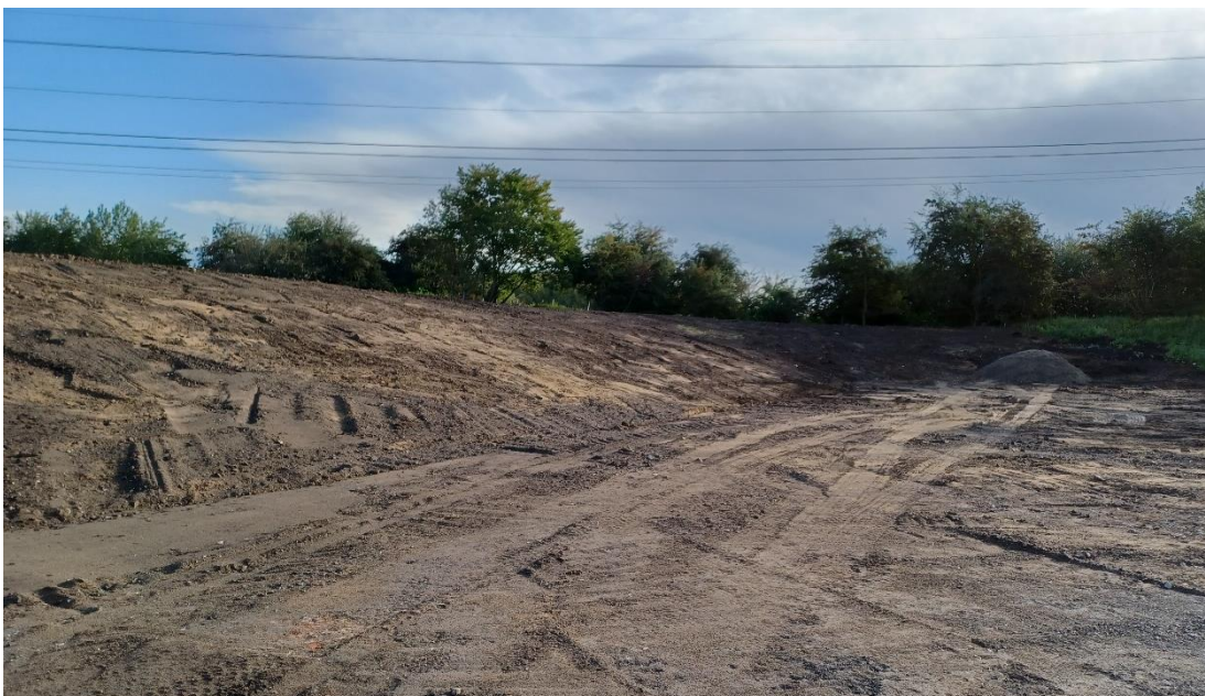
Figur 1. Slutafdækning af etape 1. Øverst: Etape 1 set fra syd mod nord. Til venstre ses det lille gashus og til højre sorteringshallen. Nederst: Etape 1 omkring midten af etapen med kig mod vest. Til venstre hæver terrænet sig, da slutafdækningen er komplet i dette område.
