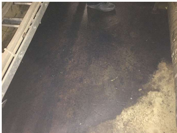
Spild på betongulv i ingeniørgang
