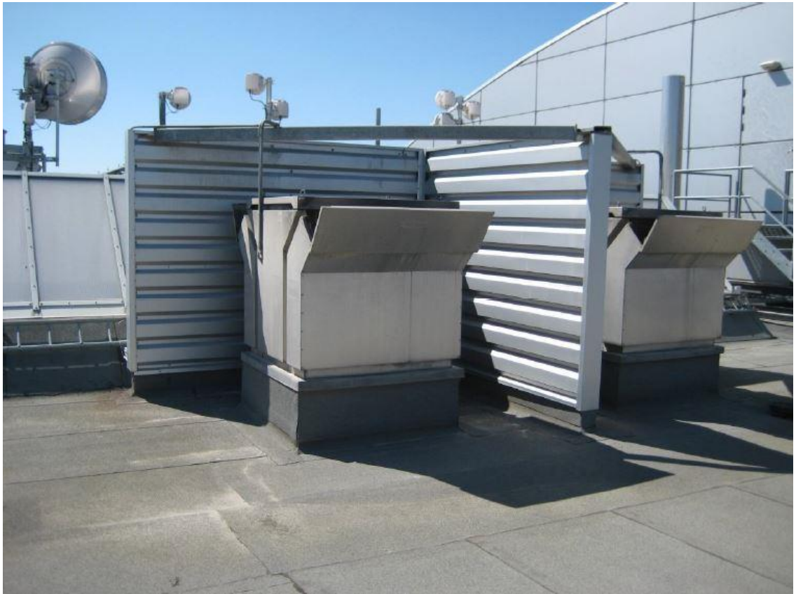
Figur 2: Kilderne V8 og V9 før støjdemping
