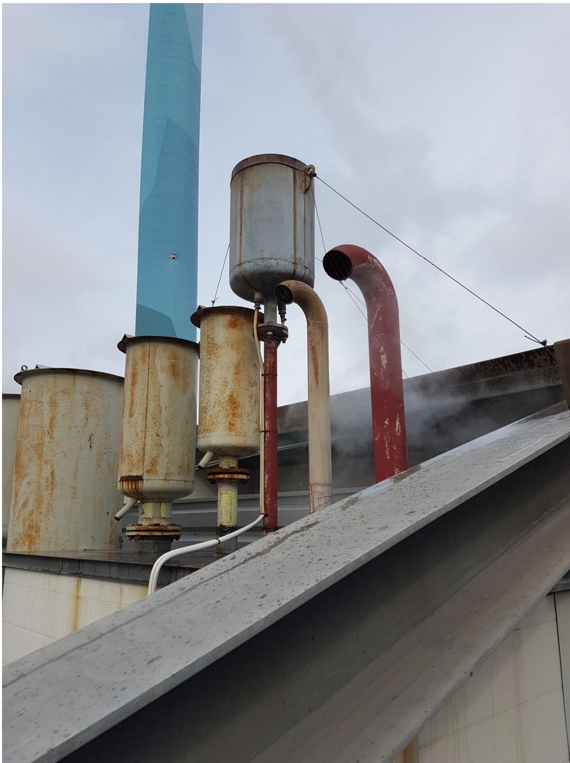
Figur 6: Dampafkast V2 efter støjdæmpning
