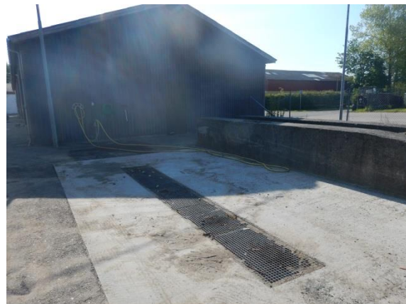
6. Vaskeplads med olieudskiller.
