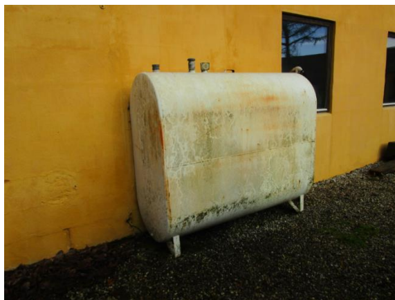
Figur 1: Olietank til fyringsolie med påfyldningsstuds
