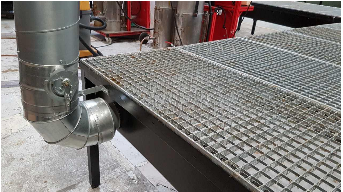
Undersug ved støbebordene.
