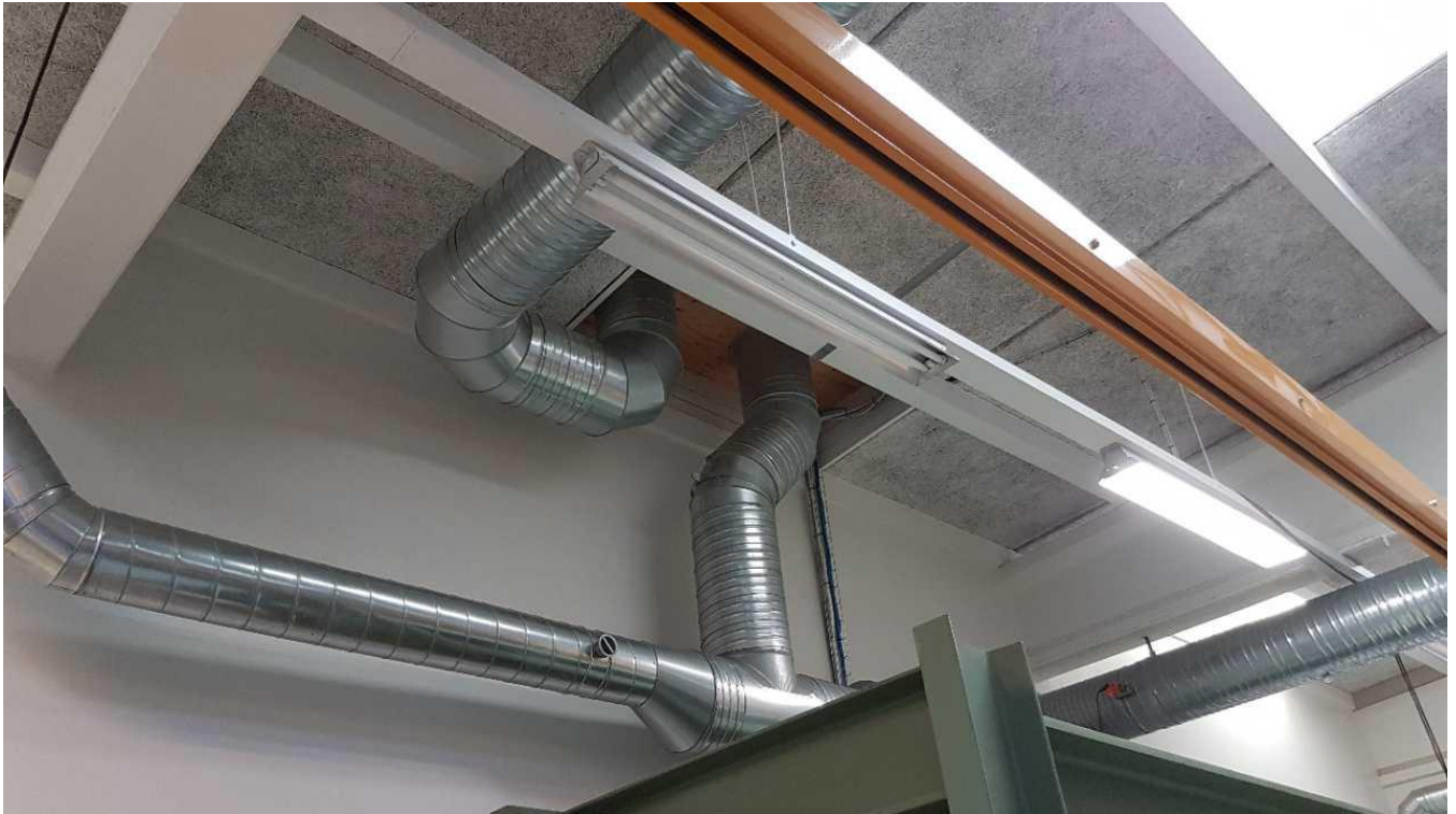
Røret til venstre er samlet afkastør fra støbebordenes undersug. Røret til højre er friskluftindtag til produktionshallen.
