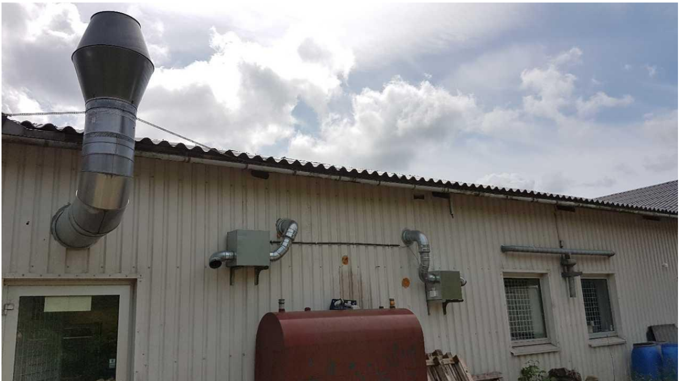
Det store afkast fra limning er ført op til fri fortynding. De to små afkast til højre er blot ført gennem muren og skal som minimum føres op til fri fortynding (fra stinkskab, polering af plast, svejsning, håndtering af støvende kattegrus).
