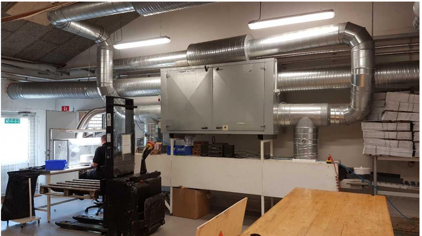
Arbejdsplads til limning samt afhærdningstunnel med udsugning via filteranlæg med F7-filter.
