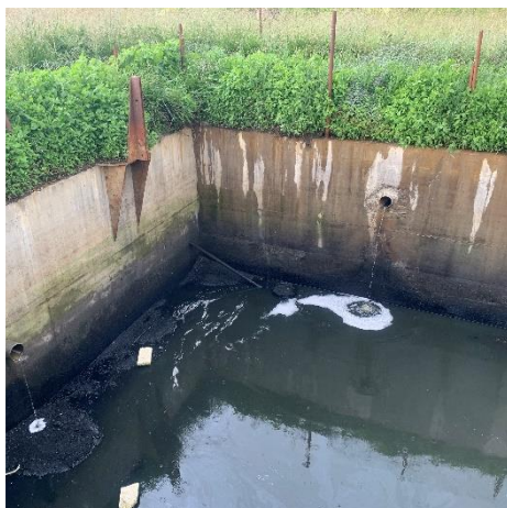
Perkolatbassin 2. Røret til venstre er tilløb direkte fra deponi, røret til højre er tilløb fra Perkolatbassin 1. Slam i bunden af bassinet
