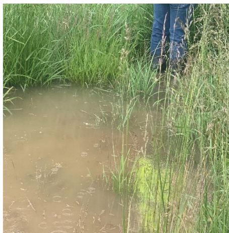
Oversvømmet og tilstoppet afløb ved Perkolatbassin 2 hvor medarbejder er placeret
