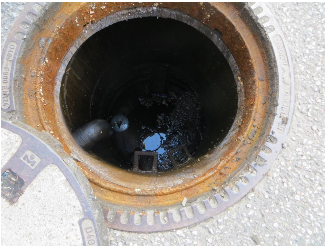
Olie- og benzinudskiller nr 2 ved indgang. Olie- og benzinudskilleren består af betonringe.
