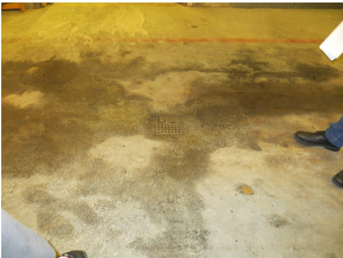
Afløb i belægning under pålæsning af flyveaske. Spildt flyveaske skyldes med vand til kloak i forbindelse med rengøring.
