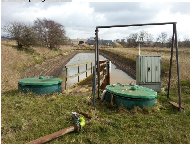
Foto 8. Perkolatbassin inden udpumpning til renselæg
