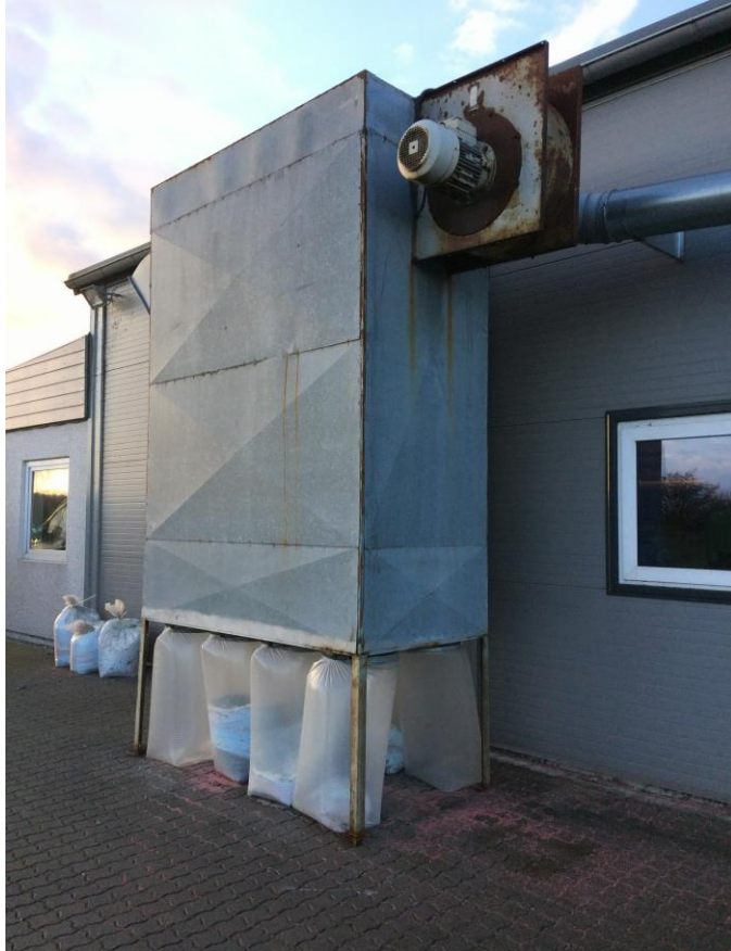
Billede 11 Ventilation – Posefilter 1
