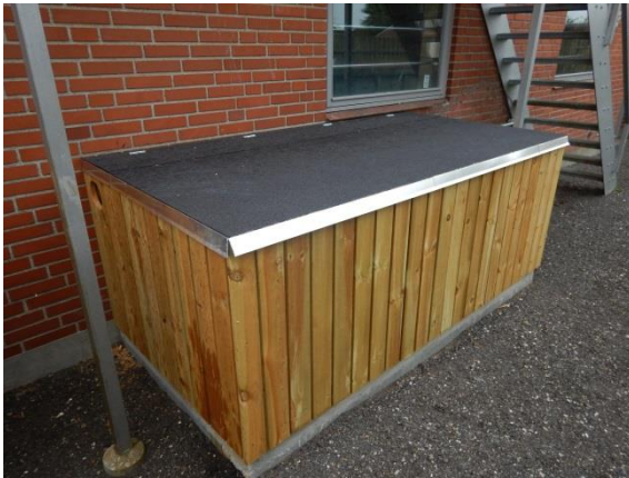
9. Kompressor i lydisoleret kasse.
