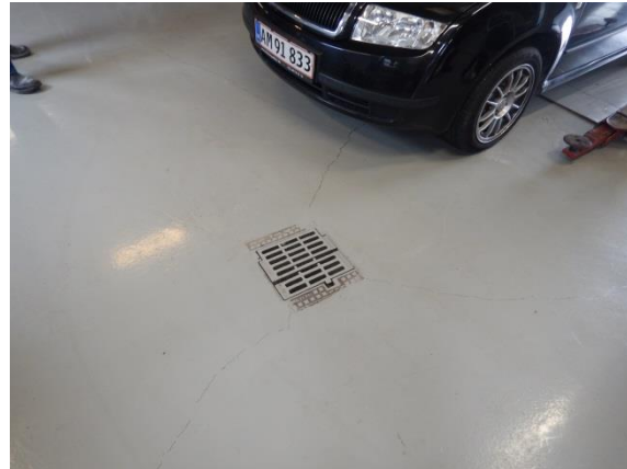
2. Afløb i værksted (løber til olieudskiller).
