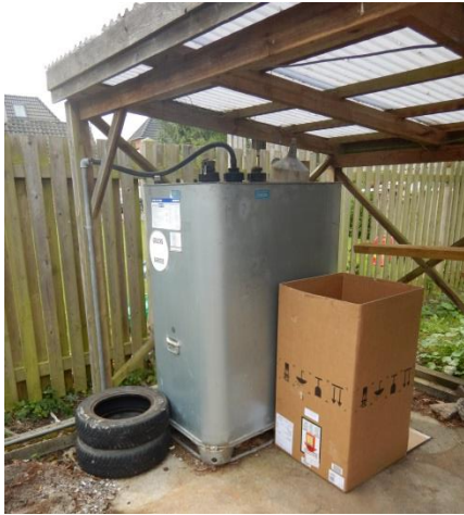
7. 1.200 l spildolietank fra 2009 under tag.
