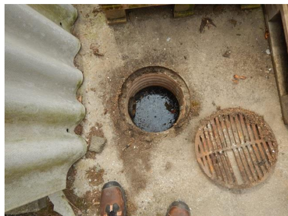
6. Afløb fra miljøplads (ført uden om olieudskiller).
