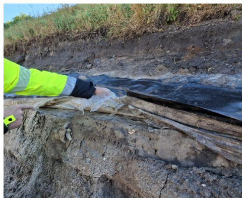
Billed 8. Fritlagt gammel membran på Enhed 1c. Polymermembran, fiberdug og landbrugsplast (fra overdækning af lermembran) er stadig intakt.
