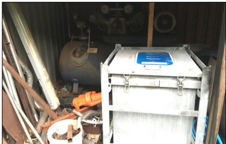
Foto 2. Kompressor placeret bag miljøcontainer.
