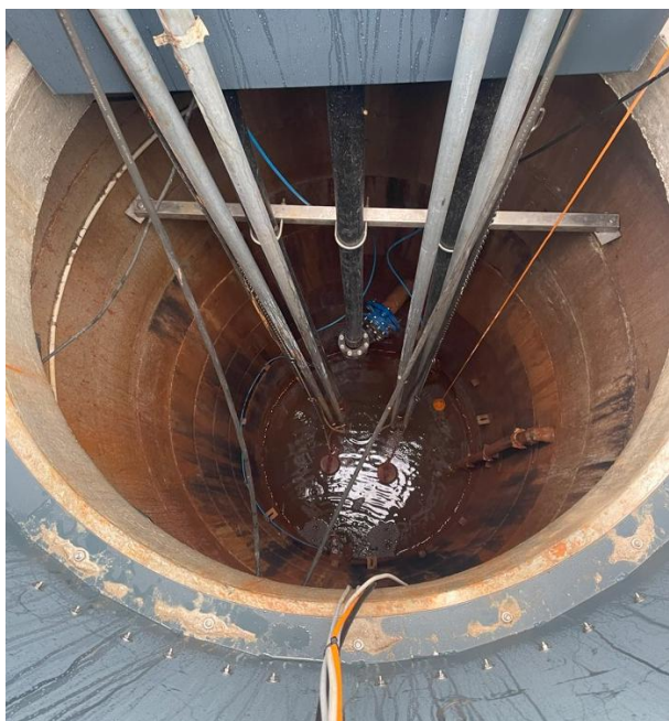
Figur 11: Pumpebrønd PB3. Perkolat fra det østlige og sydlige dræn mødes heri
