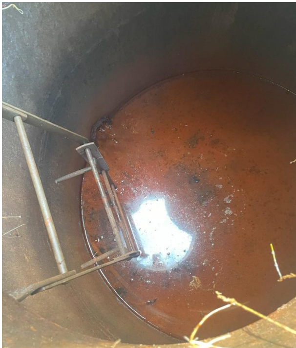
Figur 2: Drænbrønd 1 (DB1). Vandet i brønden var ved tilsynet stillestående, og der ses okker nederst i drænrøret
