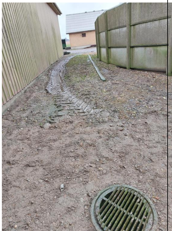
Afløb til drænsystem. Overfladevand.
