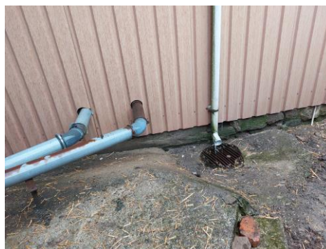
Afløb til drænsystem. Tag- og overfladevand.
