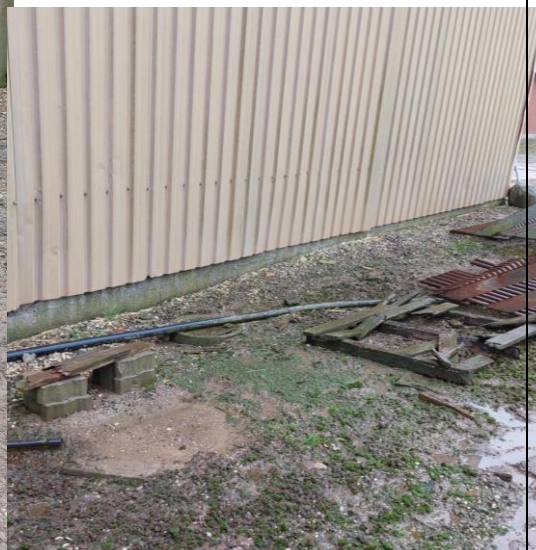
Afløb til drænsystem. Overfladevand.
