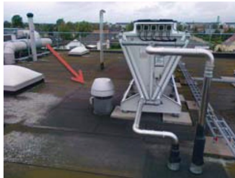
Støjkilde B21M02, Afkast på bygning 21
