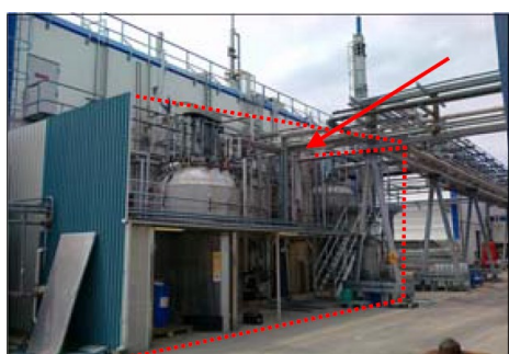
Støjkilde 74M01, Tankanlæg ved F4
