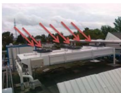
Støjkilde F8PI16KM11, Køleanlæg på F8
