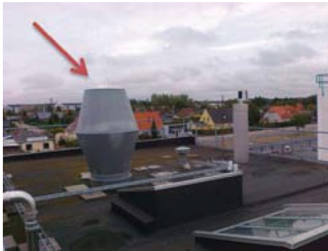
Støjkilde B21M01, Afkast på bygning 21
