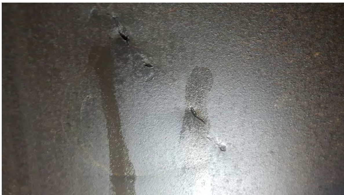
Tank 1: Få grubetæringar < 2 mm dybe
