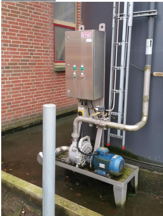
Aars Fjernvarme har en dobbeltvægget tank til ammoniakvand med lækagealarm. Ved eventuel lækage afledes ammoniakvand til dieseltankens tankgrav
