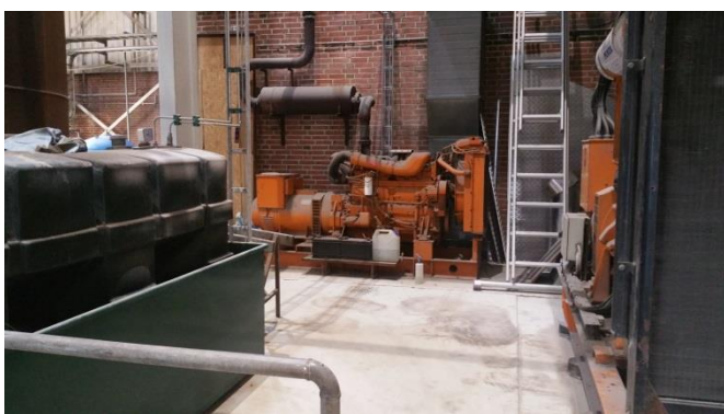
Nødgenerator 70 kVA og 330 kVA tilsluttet 57 m høj skorsten. Indendørs dieseltank forsyner lastbil, truck og nød anlæg
