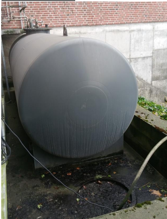
Dieseltank i tankgård. Regnvand pumpes ud aktivt.
