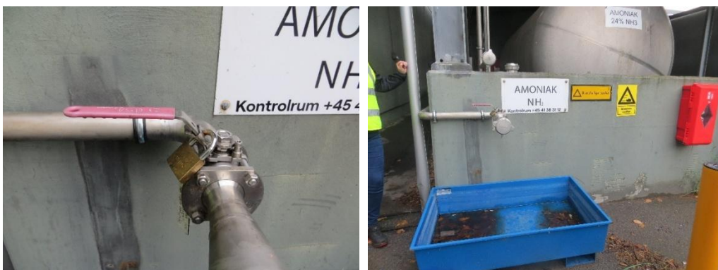
Ved påfyldningsstudsens til ammoniaktanken er der lås på, som kun kan åbnes af personalet, der har nøglen. Under studsens var der placeret en spildbakke til opsamling af potentielt spild ved påfyldning af tank
