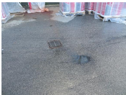
Dyb lunke ved afløb ved anlæglinje 3.
