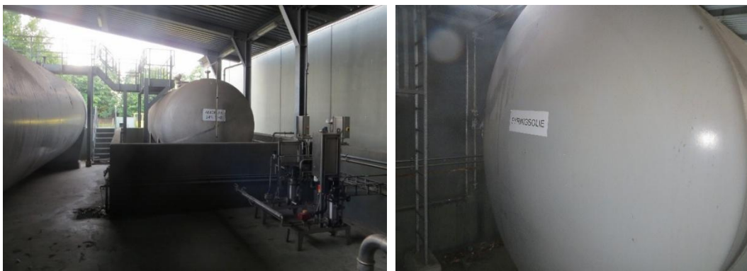
Ammoniaktank i særskilt tankgård i olietankens tankgård. Ammoniakpumper (ses i højre side) står i fyringsolietankens tankgård. Olietank til støttebrændsel (ses delvist i venstre side og på billedet til højre) står i egen tankgård.
