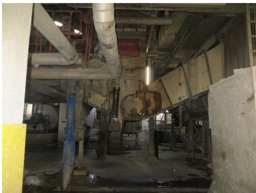
Slaggenedfaldet i slaggebadet under ovnen til anlæg 4. Til højre ses det lukkede slaggebånd.
