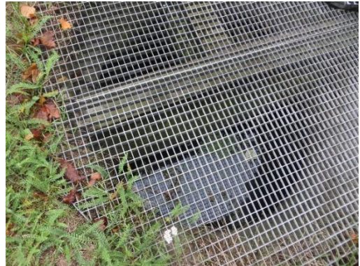
Udløbsbrønd kan afspærres hvis der er spild på belægninger og hvor overfladevand er løbet til bassinet.
