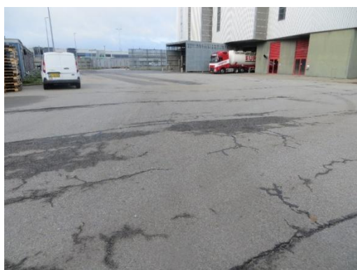
Asfaltbelægninger ved udkørsel af restprodukter ses der revne. Revner af denne type er generelt acceptable. Den nærmeste revne viser begyndende gennembrud uden at denne endnu er kritisk.
