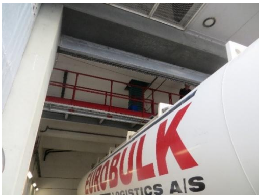
Udledning af kedelaske og flyveaske direkte fra askesolie på anlægslinje 4 og direkte i tankbil, som er den bedste løsning for forebyggelse af støv.
