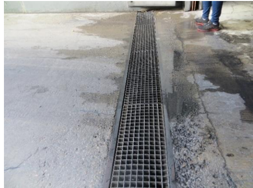
Belægningen omkring risten i porten er tæt. Bærer dog præg af begyndende forvitring, som uden vedligehold vil føre til utæthed.
