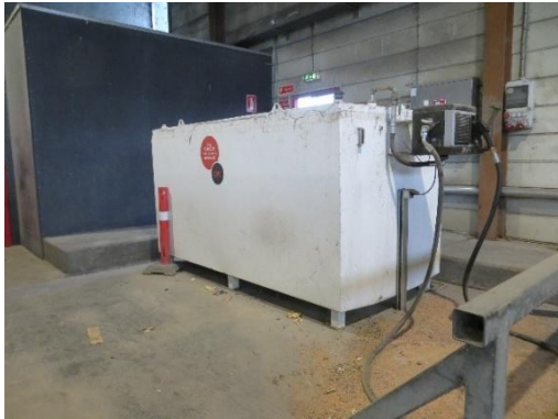
Olietank placeret i modtagehal. Anvendes til tankning af egne køretøjer. Tanken er beskyttet mod påkørsel, men der er ikke spilbakke til brug ved tankning.
