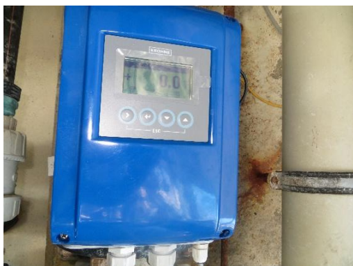
Flowmåler på spildevand. Der var ikke udledning på tilsynstidspunktet.
