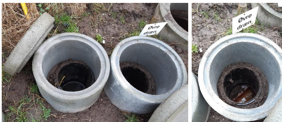
Figur 4. Højt vandspejl i nedre dræn. Til venstre: Nedre dræn (tv) og øvre dræn (th). I det nedre dræn ses vandspejlet. Til højre: kig ned i det øvre dræn, hvor vandspejlet ikke er synligt.
