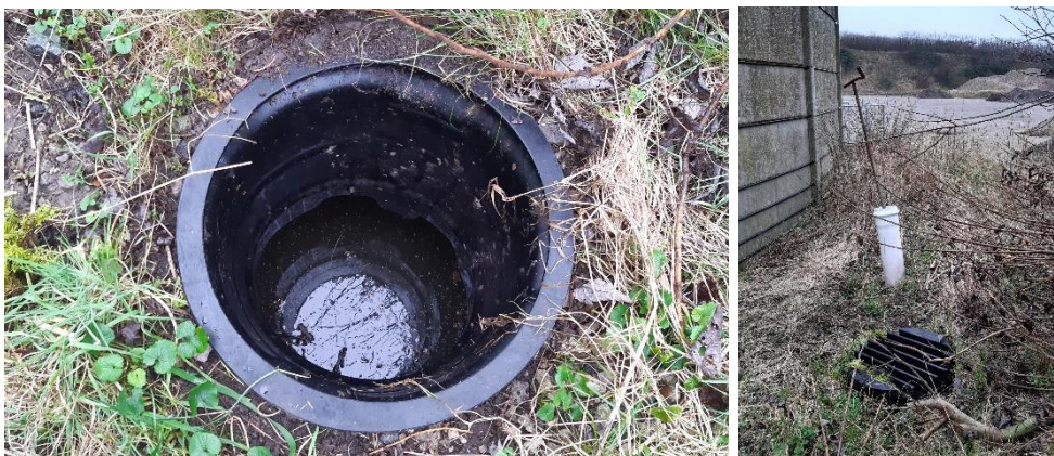
Figur 7: Olieudskiller. Til venstre: Kig ned i olieudskilleren. Til højre: Olieudskillere ns omgivelser.
