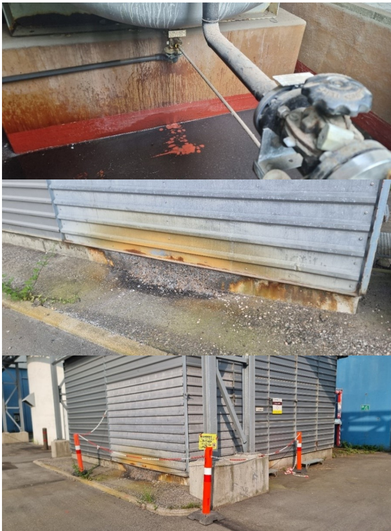
Figur 1 Billeder fra spildet fremsendt til Københavns Kommune af HOFOR Amagerværket den 20. august 2024.
