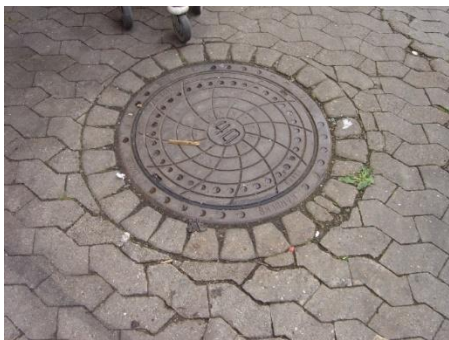
Dæksel for fedtudskiller mod Torvegade (slagteriet).
