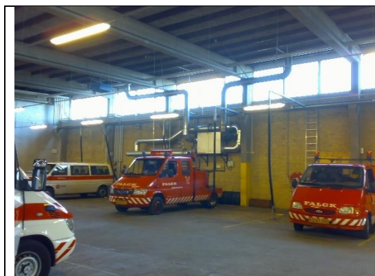
Ventilationsanlæg slanger til udsugning af udstødningsgasser.
