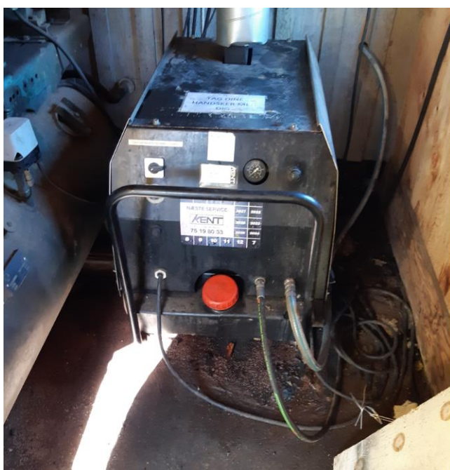
Hedtvandsrenser med kattegrus og fugt under.
