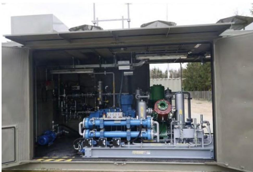
Figur 3 - Kompressor container med åbenstående kompressor rum.
