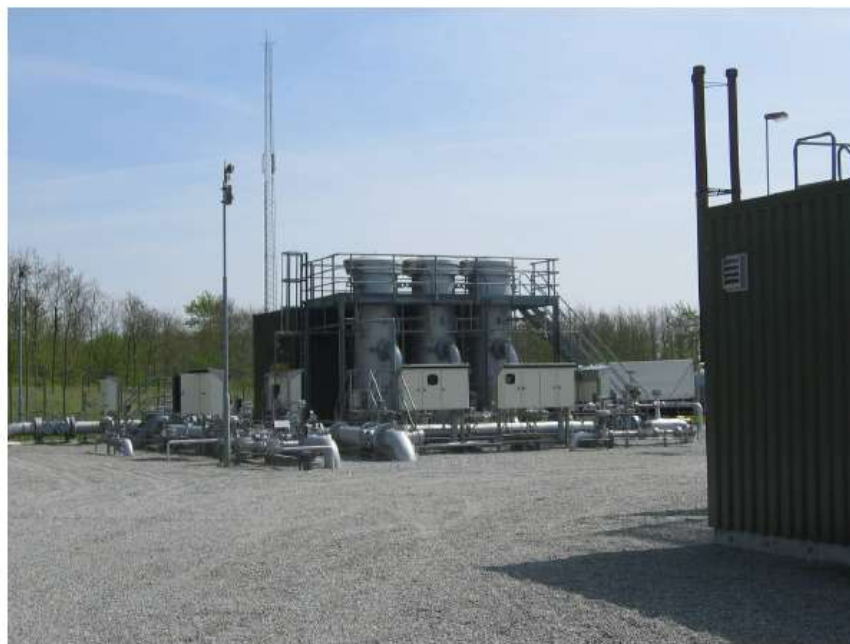
Figur 8.3 Filtre ved stationsmålebygning
