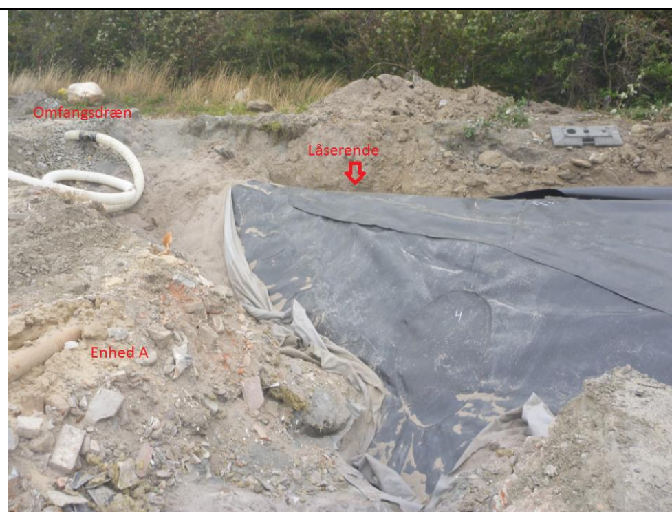
Foto 5. Foto af dele af låserenden ved enhed A mod Almegårdsvej. Det eksisterende omfangsdræn skal videreføres bag ved renden. Er område 4 en udbedring?
