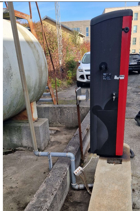
Foto 4 Ny stander med synlig rørføring.
