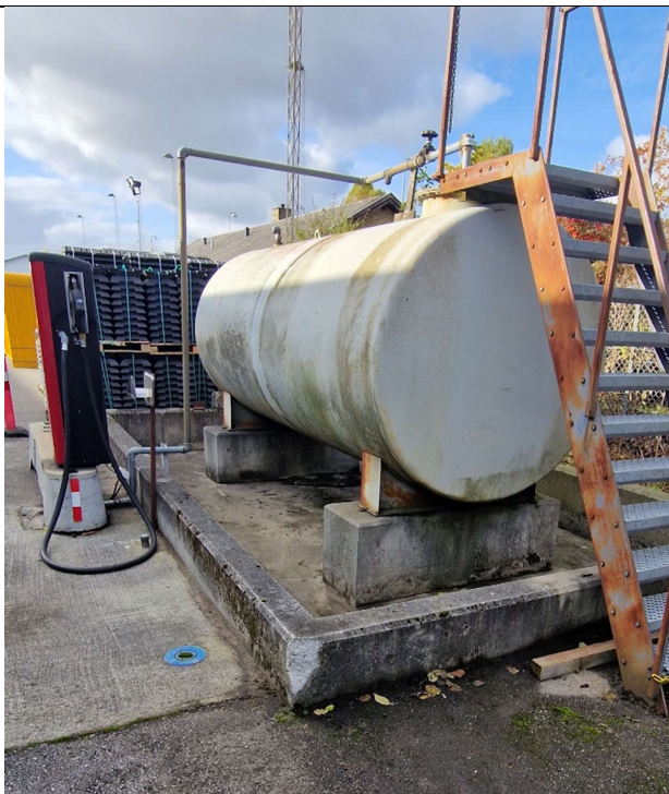
Foto 3 Stor olietank med 10.000l og ny stander.
