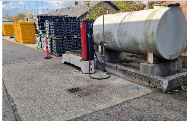
Foto 2 Stor olietank med 10.000l og ny stander.
